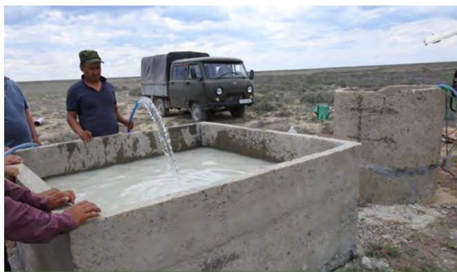
Обустройство водопоя для диких животных на территории заказника. Фото Комплексный (ландшафтный) заказник «Сайгачий»
